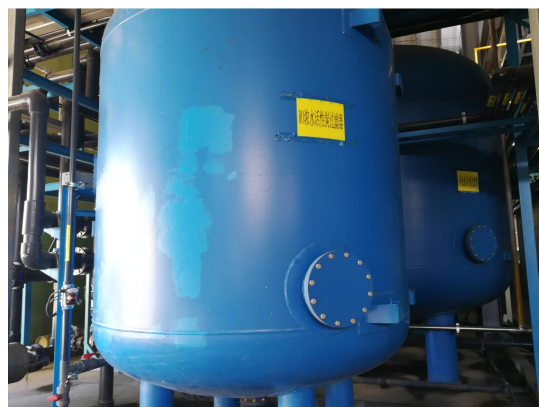
活性炭过滤器
