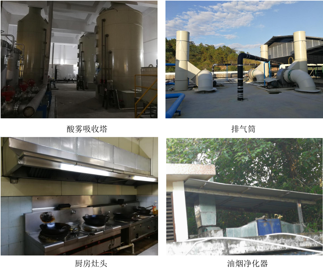
图4-10 废气处理设施
