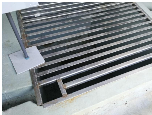
导流槽及低位应急事故槽
