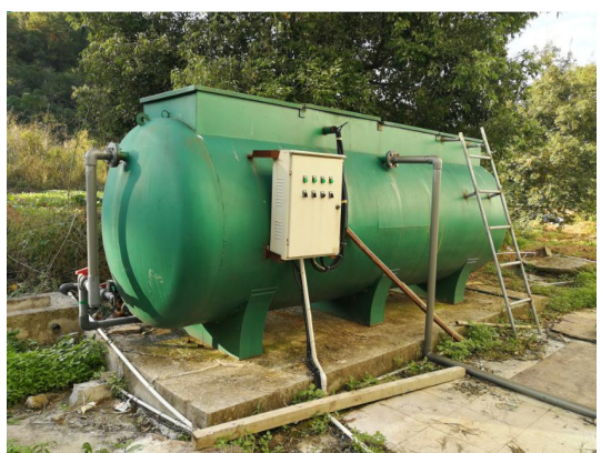
一体化生化处理设施
