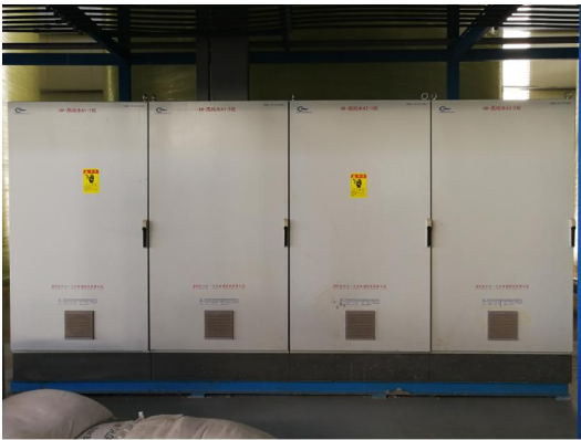
纯水制备系统控制柜
