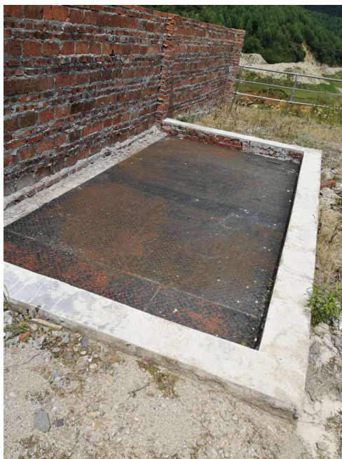
图12-1 变电站事故油池
